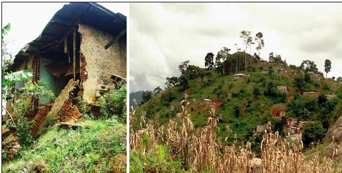
8a. Effondrement d'une habitation 8b. Maisons exposées à des risques de glissement de terrain
